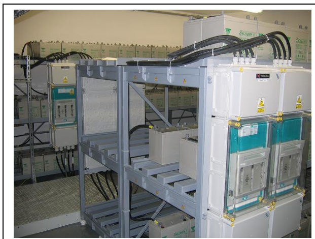
Stojak z pomieszczenia RDC w obiekcie BEYOND – ujęcie pierwsze
